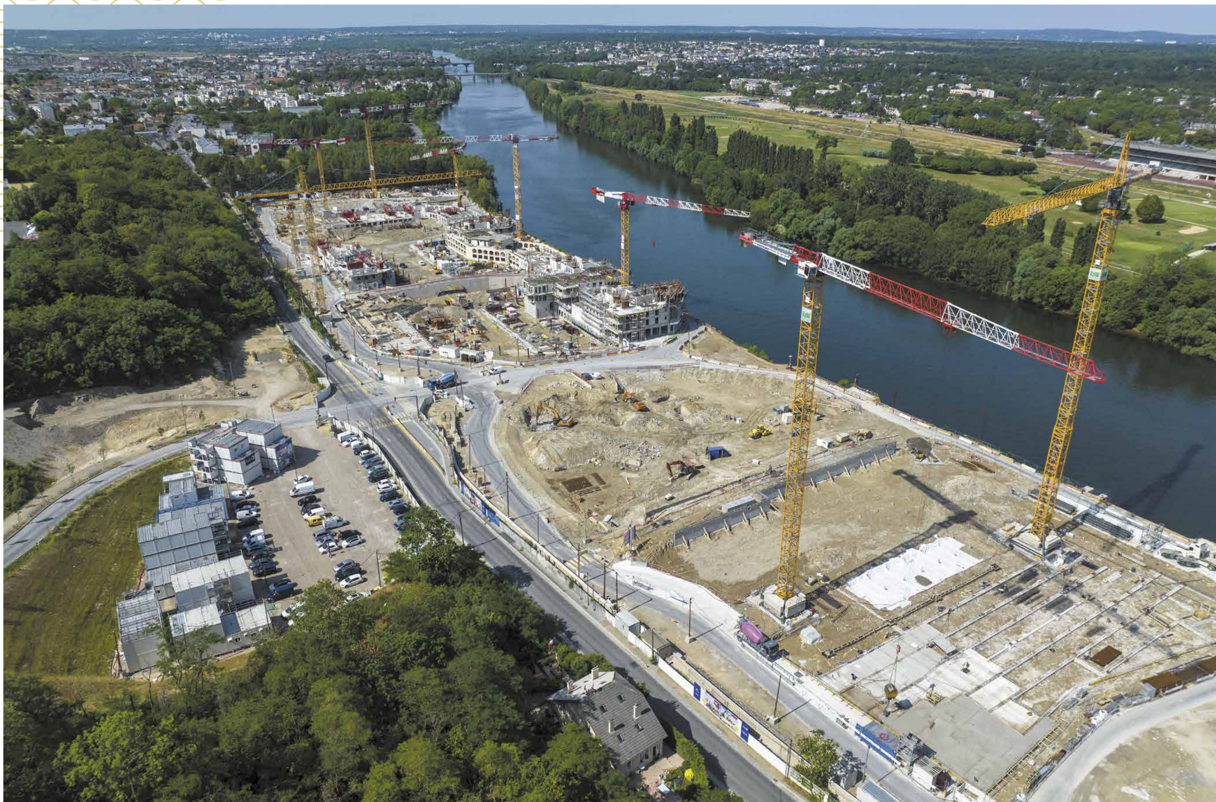
Été 2023 : le quartier sort peu à peu de terre. Les promoteurs sont arrivés en fin d'année 2022, les travaux des 750 premiers logements ont commencé en janvier 2023. Depuis, le chantier bat son plein. © Devisubox
